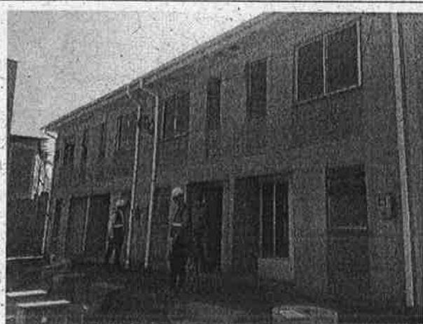
Fotografía N° 1: Estado de avance de obras viviendas ubicadas en Pasaje Salitrera Rosario, comuna de Alto Hospicio, actualmente en ejecución por Constructora Norte Andino Ltda.
