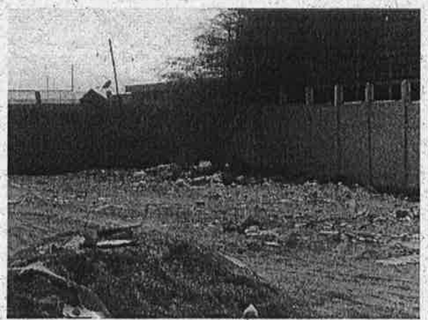
Fotografía N° 10: Falta de aseo y cuidado de la obra. Partida global pagada íntegra y extemporáneamente en el estado de pago N°1.
