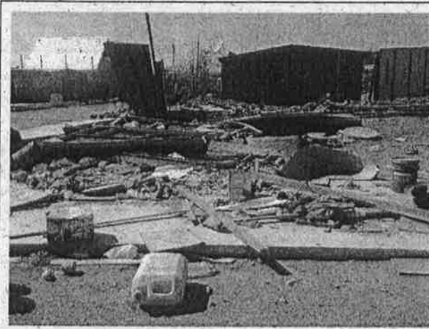
Fotografía N° 9: Falta de aseo y cuidado de la obra. Partida global pagada íntegra y extemporáneamente en el estado de pago N°1.
