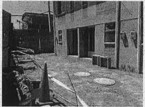
Fotografía N° 6: Obras pendientes de ejecución por parte de Constructora Norte Andino Ltda., en viviendas ubicadas en calle Cerro Esmeralda, comuna de Alto Hospicio.
